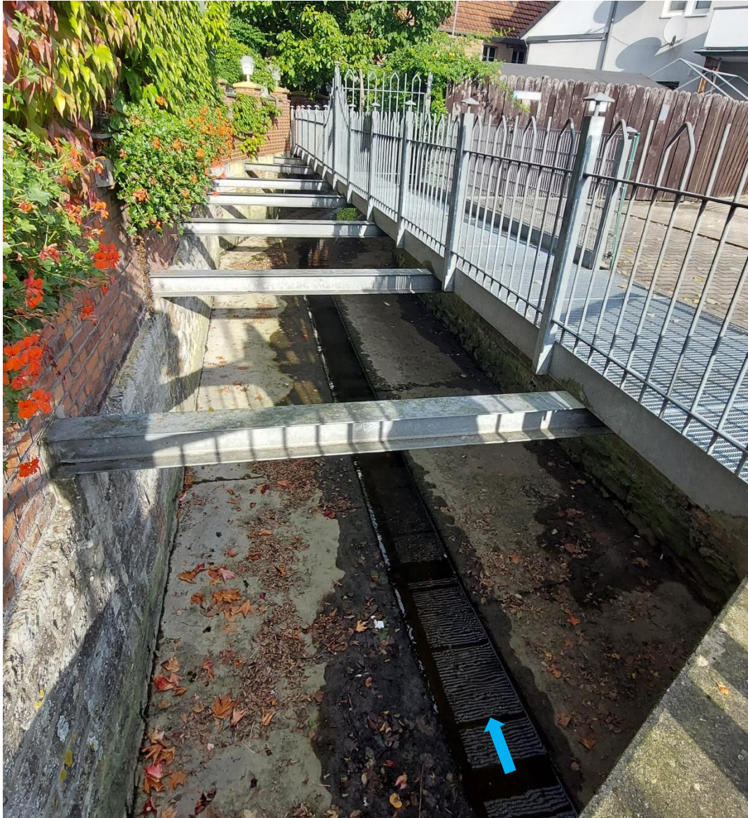
Abbildung 14: teilweise überbauter Brüggelbach unterhalb der Stiftsbleiche, beidseitig Ufermauern, NW-Rinne mit Betonbermen, Stat. 4+450
