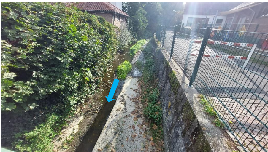
Abbildung 15: oberhalb der Stiftsbleiche, beidseitig Ufermauern, NW-Rinne mit tlw. abgesackten Betonbermen, Stat. 4+450
